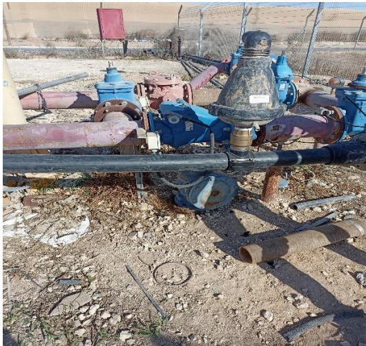
צינור פלסטיק מאולתר
